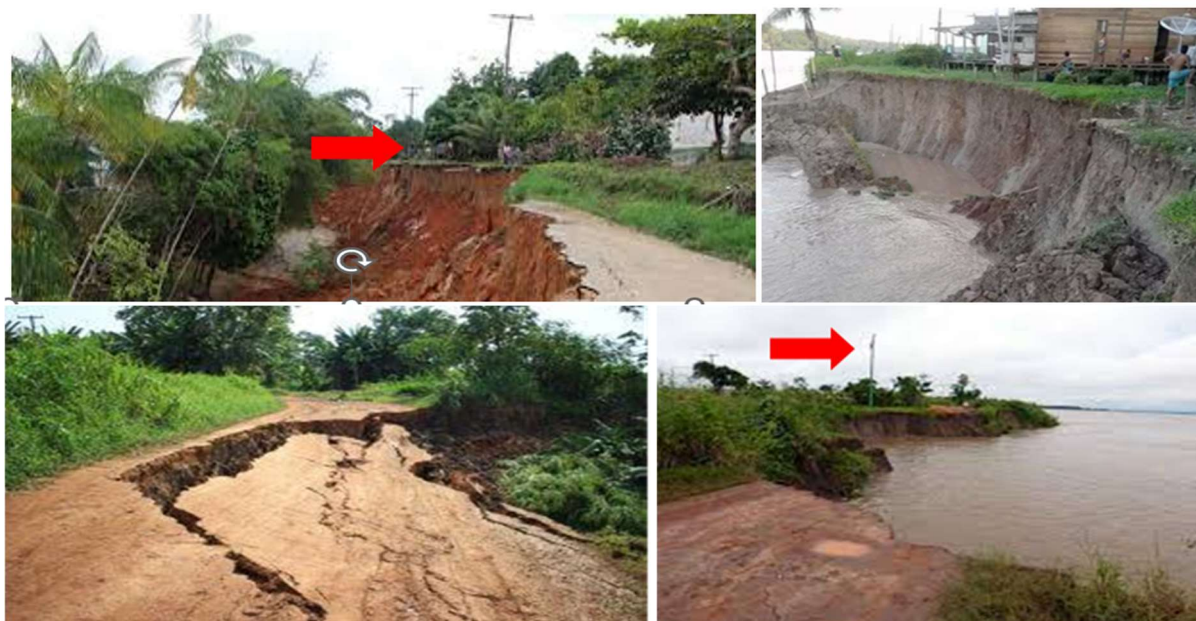
Figura 7 – Fenômeno terras caídas.
