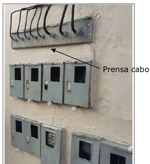
Figura 11 – Adequação com cabo concêntrico e instalação de prensa cabo na parte frontal da caixa de derivação
