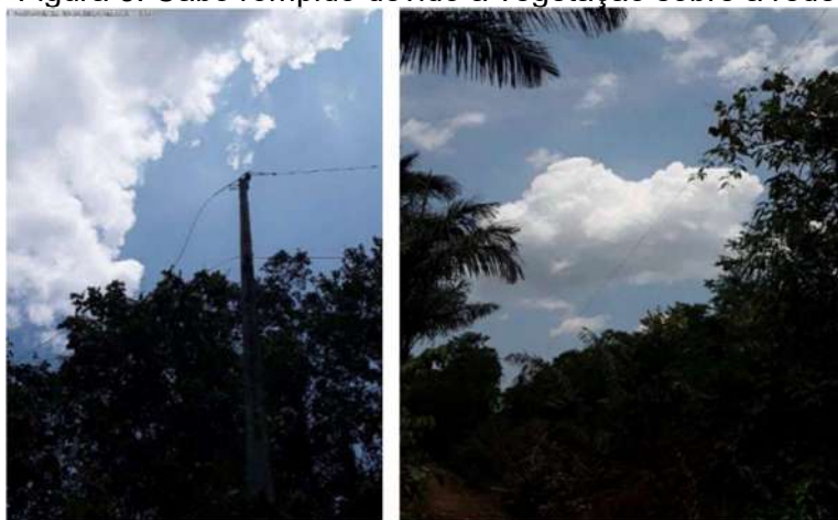
Figura 3. Cabo rompido devido a vegetação sobre a rede.
