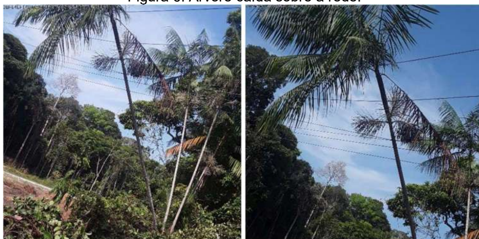
Figura 6. Árvore caída sobre a rede.
