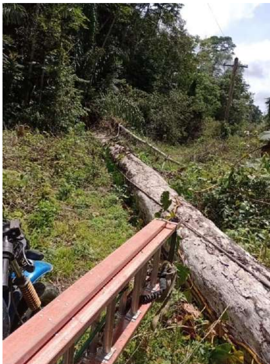
Figura 4. Cabo rompido devido Árvore e Vegetação.
