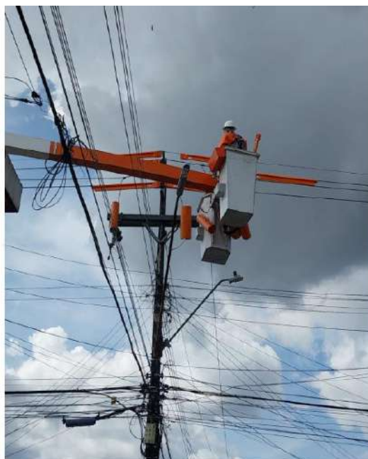
Figura 8. Forte ventania trançou a rede de telecomunicação com a rede de média tensão.
